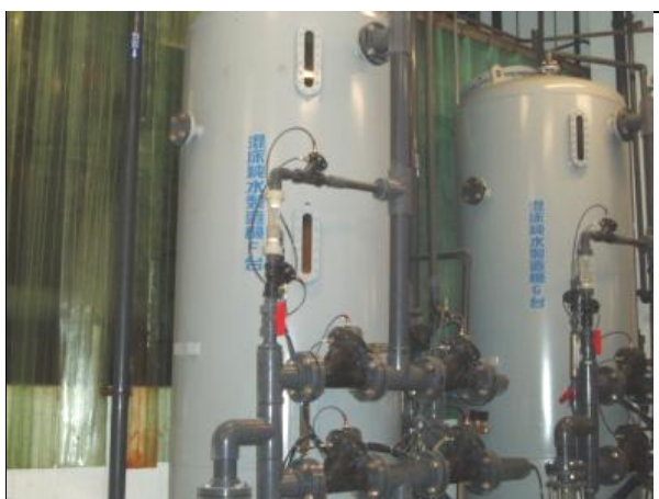
純水系統混床試用水回收至軟水池供應 RO 原水使用
