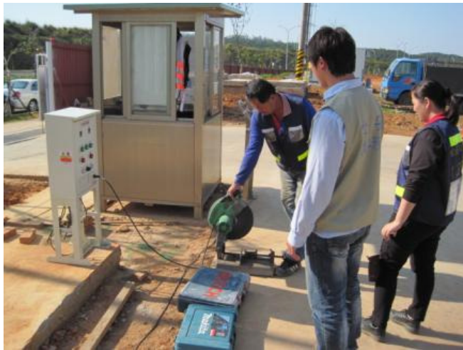
電器設備進行漏電測試檢查並張貼合格標籤
