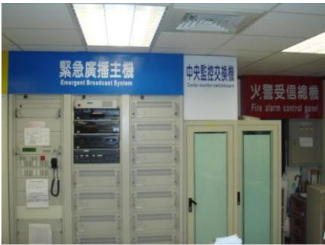
設置中央監控中心
