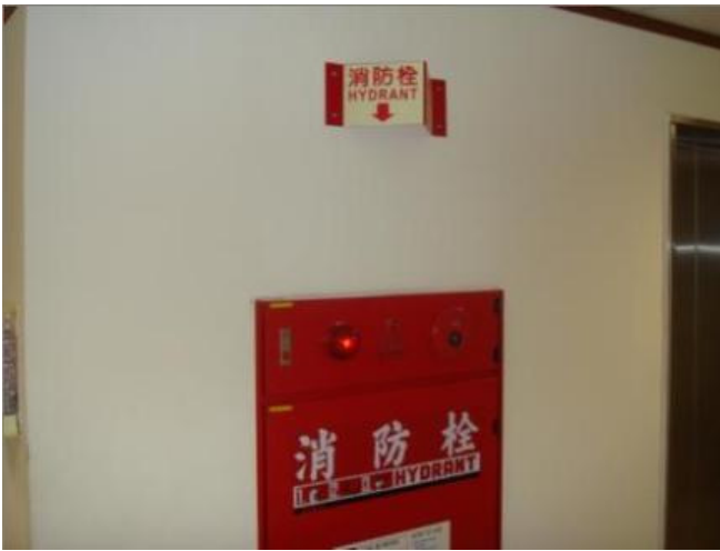
消防栓、箱增加立體標示
