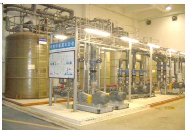
切割及研磨廢水分類分管收集回收
